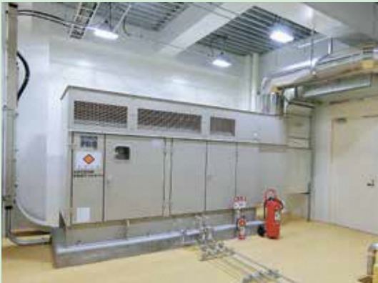
発電機室(340KVA)
