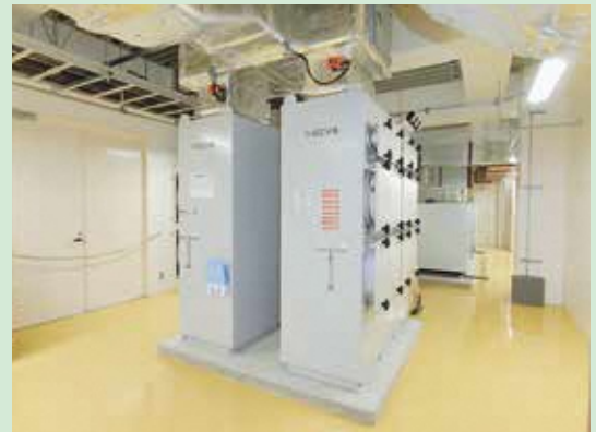
フィルター・ファンルーム
